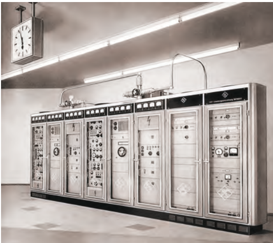
1963: VHF radio transmitter with mit 2 \times 5 kW
